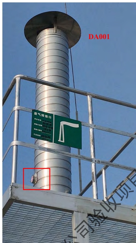
DA001 废气排放口的采样口、标识及采样监测平台
