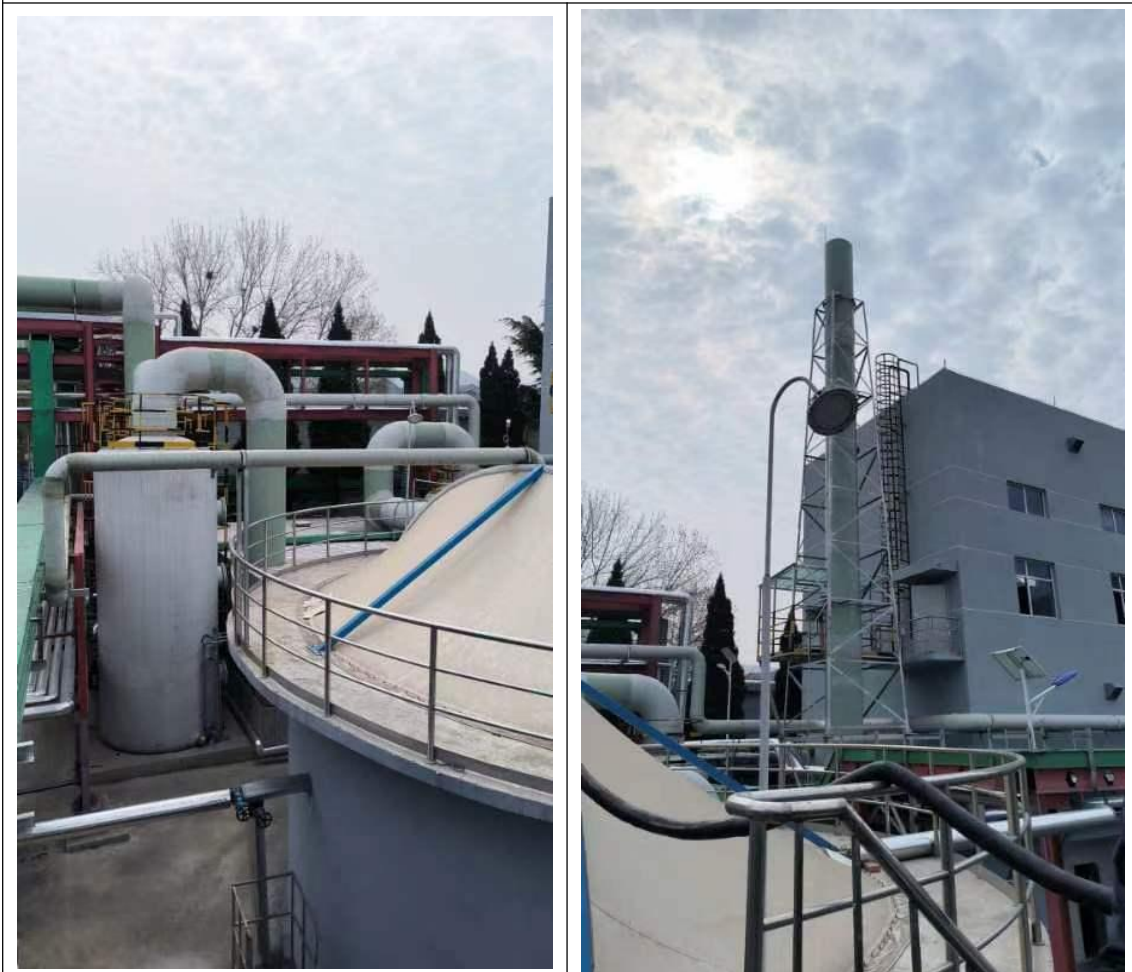
污水处理站废气
